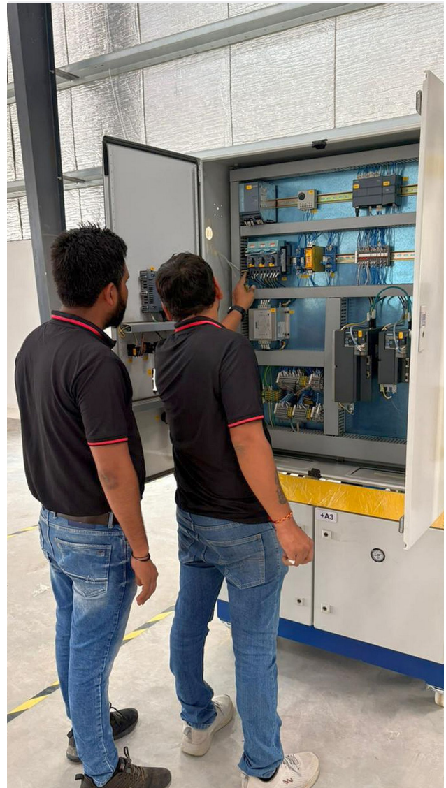
Am neuen Standort von TARTLER India in Ahmedabad beginnen die Mitarbeiter derzeit mit der Endmontage der ersten Dosier- und Mischmaschinen für die Kunststoffverarbeitung.
