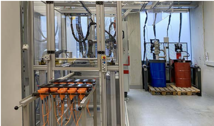
Die Nachfülleinheit der neuen Elektroverguss-Station steht direkt neben Dosier-/Mischanlage und Roboterzelle. Sie gewährleistet die prozesssichere Nachfüllung von Kunstharz u. Härter aus zwei 200-Liter-Fässern.
