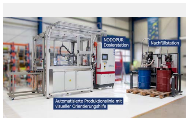
Auch bei der Vakuuminfusion von Epoxidharzen – zum Beispiel im Bootsbau – setzen die hocheffizienten Dosier- und Mischanlagen von TARTLER technische Maßstäbe.
